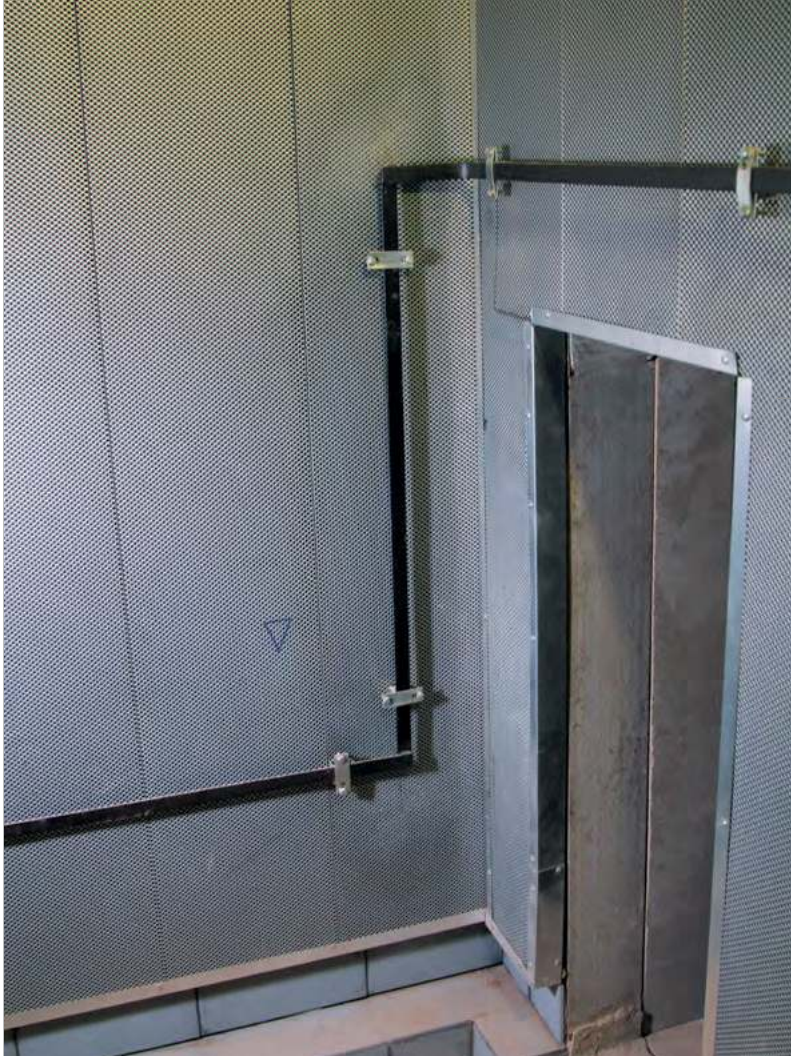
ЖК «Снегири» (техническое помещение), г. Москва
